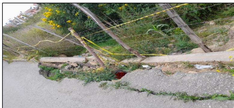
Figura 3. Estado del talud en José Joaquín Camacho
